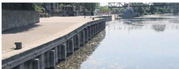
Muss in ihren Fundamenten erneuert werden: die Kaimauer am Weserufer. Wal
