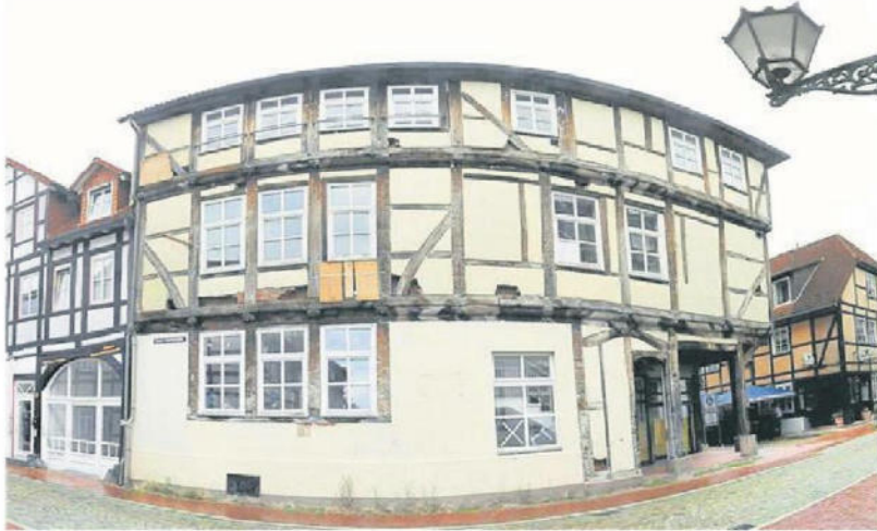
Keine Rettung in Sicht: Das Domeierhaus an der Neuen Marktstraße verfällt seit vielen Jahren. FOTO: DANA
